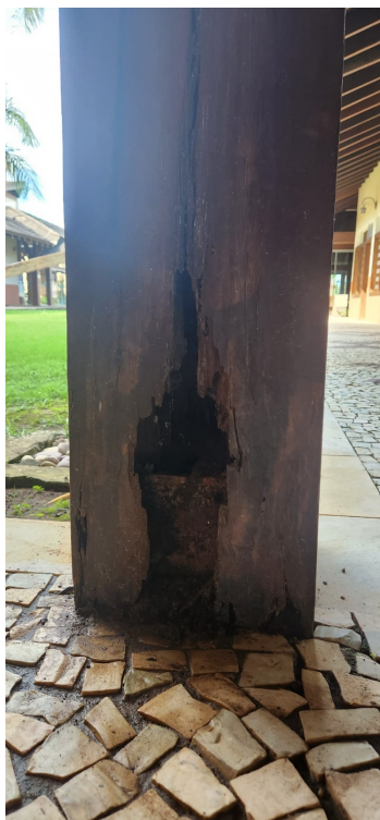
Figura 2: Estado de deterioração do pilar P1.
