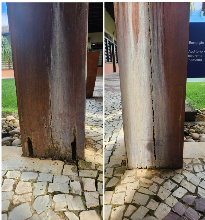
Figura 3: Estado de deterioração do pilar P4.
