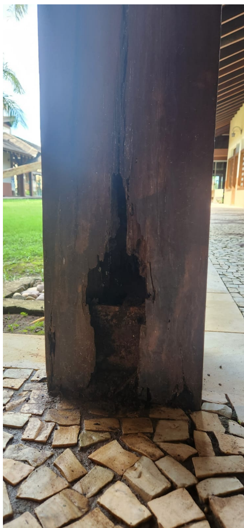
Figura 2: Visão do pilar deteriorado
